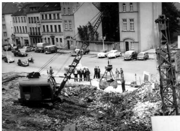
Trümmerräumung an der Nordseite des Marktes, im Hintergrund die Reste des Hauses der Familie Frings. (Stadtarchiv Neuss, E.02.01)
