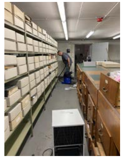
Trockenlegung des Kellermagazins in dem die eingemeindeten Orte lagern (Stadtarchiv Neuss)
