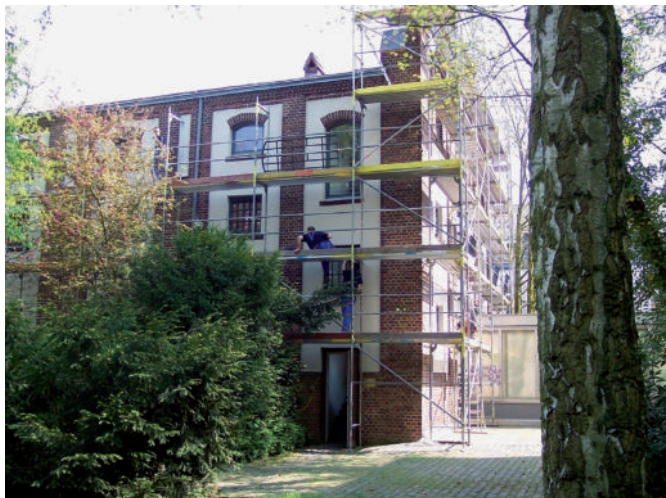
Der Austausch der Fenster im Magazingebäude im Jahr 2009 (Stadtarchiv Neuss)
